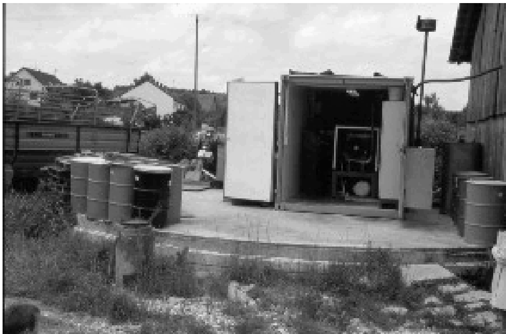
Abbildung 4: Fermenter und Blockheizkraftwerk (BHKW) der Anlage A (Foto: Klages, KTBL, 2003)
